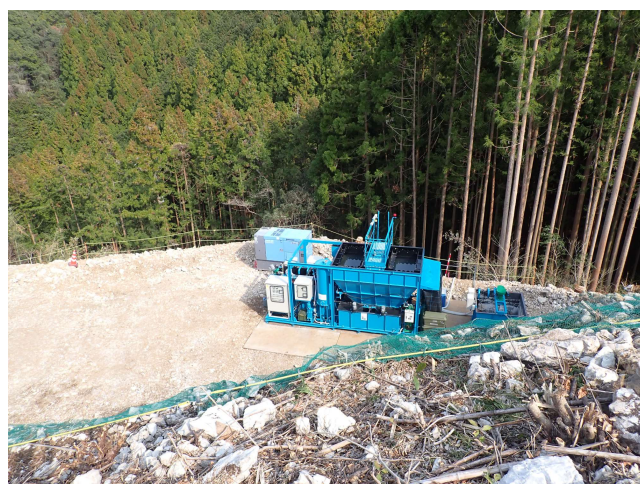
濁水処理設備
