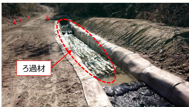
水路内のろ過材（令和6年3月10日撮影）
