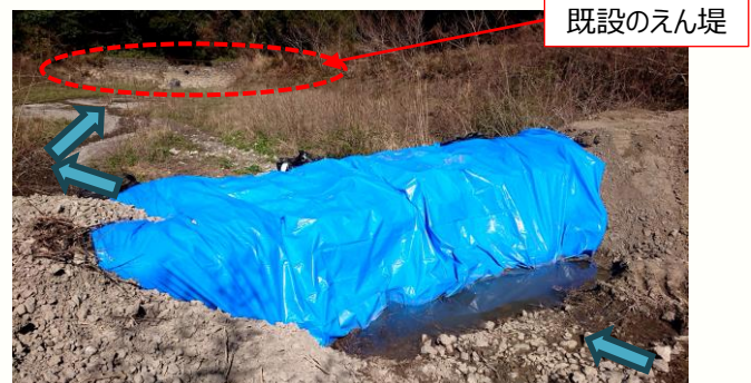
えん堤内に設置した沈砂池（令和6年3月10日撮影）
